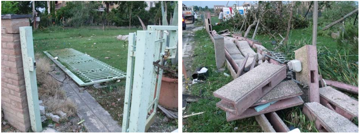
Fig. 6.3 – A sinistra cancello abbattuto dal tornado, a destra muretto demolito. Foto di Alberto Gobbi.
