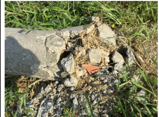
IMMAGINE 2: D.I. DANNEGGIATO O PRIMA DEL DANNO
