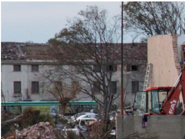
IMMAGINE 1: D.I. DANNEGGIATO
