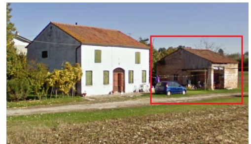
IMMAGINE 2: D.I. DANNEGGIATO O PRIMA DEL DANNO
