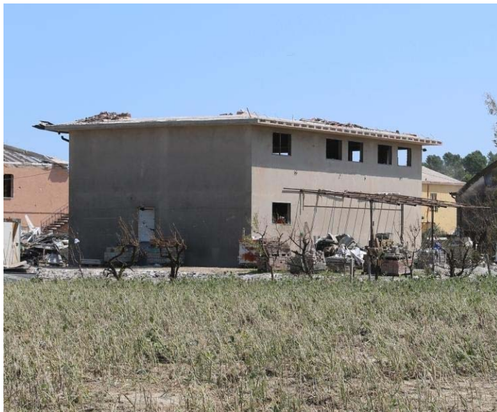
IMMAGINE 1: D.I. DANNEGGIATO
