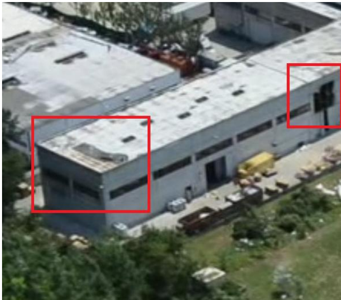
IMMAGINE 1: D.I. DANNEGGIATO
