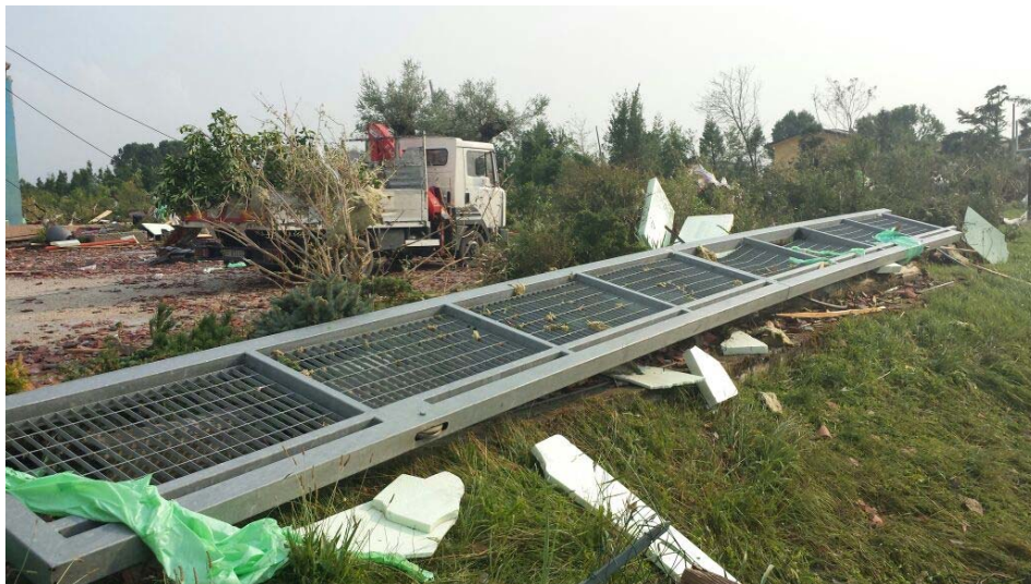
IMMAGINE 1: N.D.I. DANNEGGIATO
