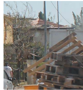
IMMAGINE 2: D.I. DANNEGGIATO O PRIMA DEL DANNO
