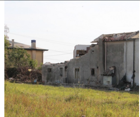
IMMAGINE 2: D.I. DANNEGGIATO O PRIMA DEL DANNO
