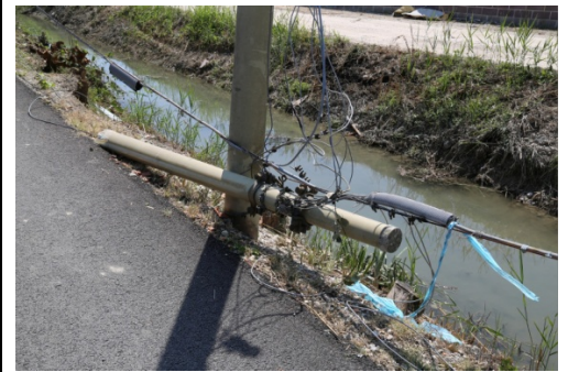
IMMAGINE 2: D.I. DANNEGGIATO O PRIMA DEL DANNO
