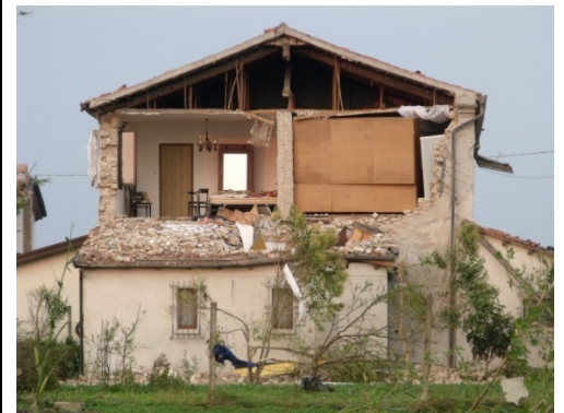
IMMAGINE 2: D.I. DANNEGGIATO O PRIMA DEL DANNO
