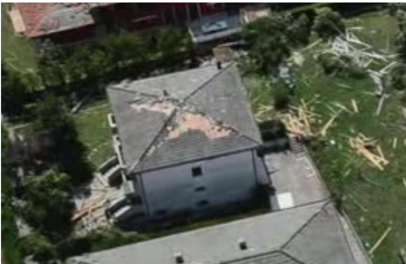
IMMAGINE 1: D.I. DANNEGGIATO
