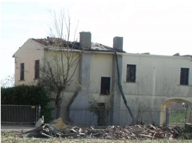
IMMAGINE 1: D.I. DANNEGGIATO
