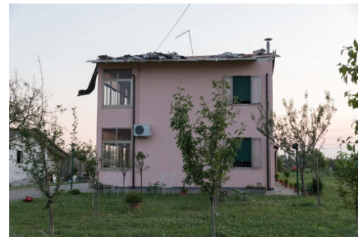
IMMAGINE 2: D.I. DANNEGGIATO O PRIMA DEL DANNO
