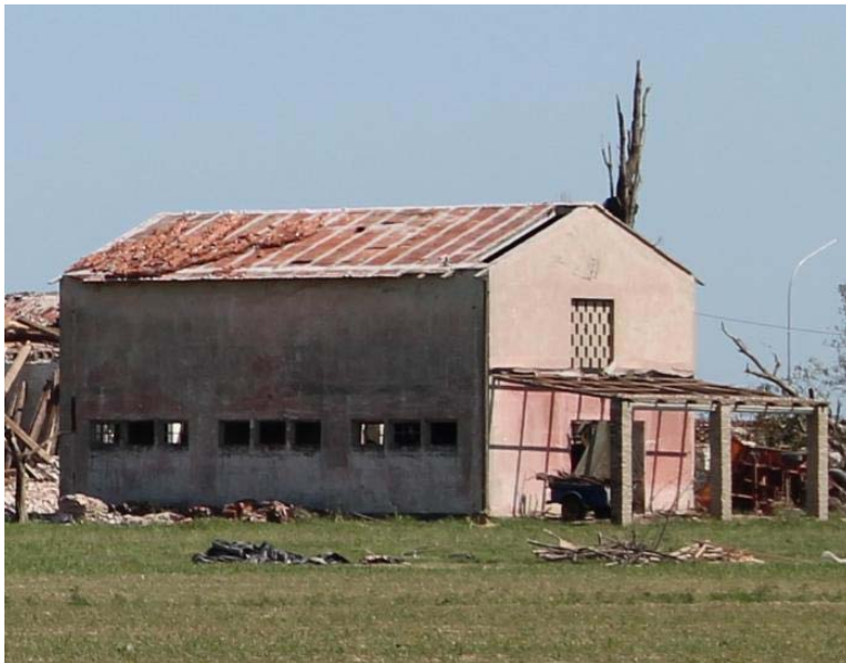
IMMAGINE 1: D.I. DANNEGGIATO
