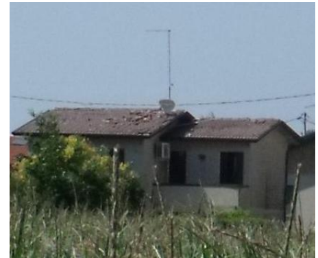
IMMAGINE 2: D.I. DANNEGGIATO O PRIMA DEL DANNO
