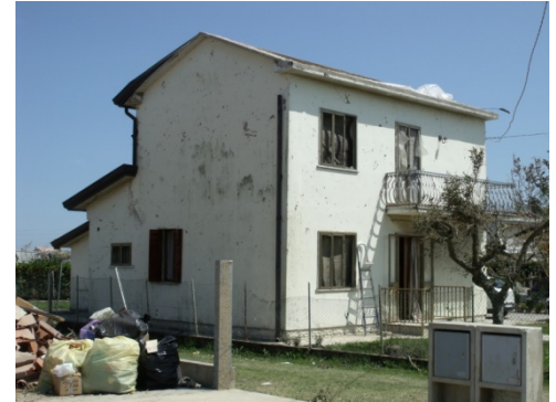
IMMAGINE 2: D.I. DANNEGGIATO O PRIMA DEL DANNO
