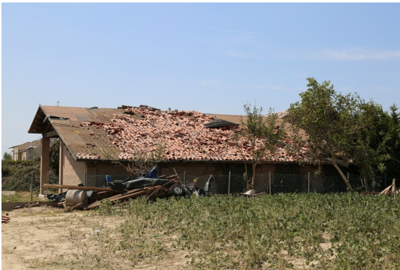
IMMAGINE 1: D.I. DANNEGGIATO
