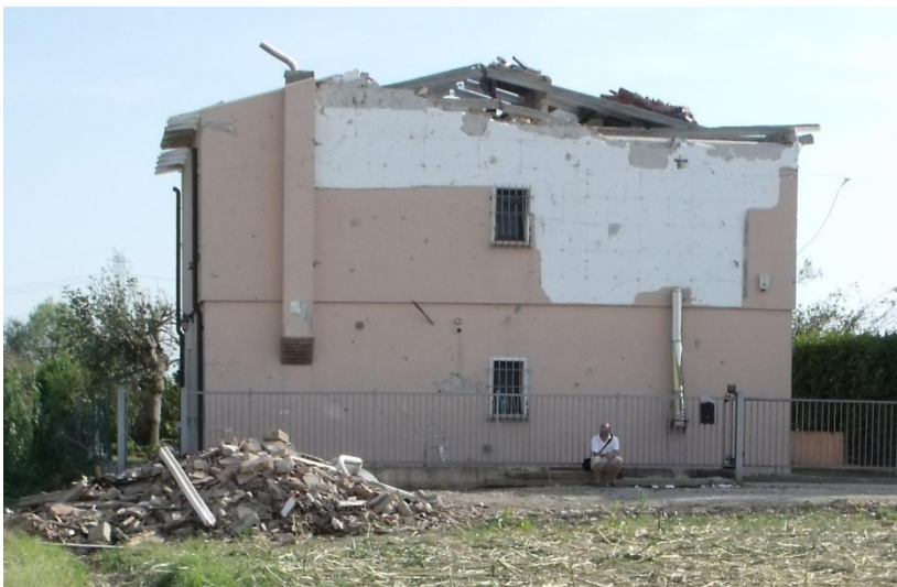
IMMAGINE 1: D.I. DANNEGGIATO
