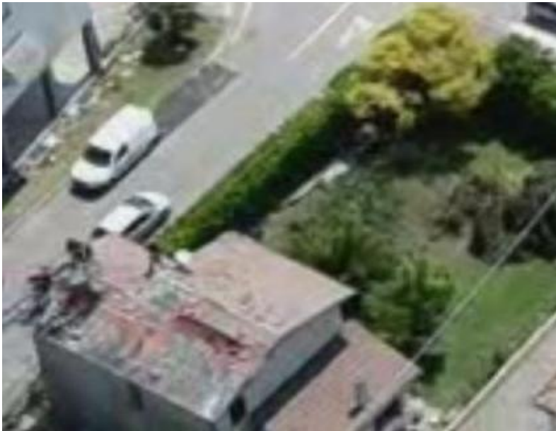
IMMAGINE 1: D.I. DANNEGGIATO
