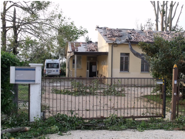
IMMAGINE 1: D.I. DANNEGGIATO
