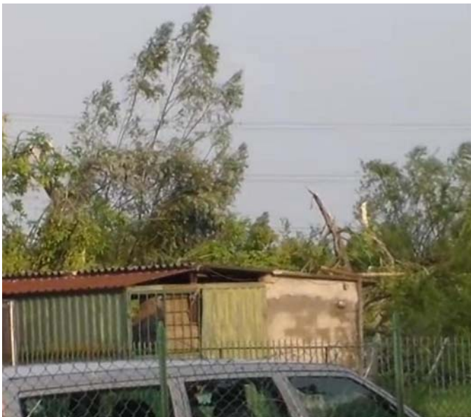
IMMAGINE 1: D.I. DANNEGGIATO
