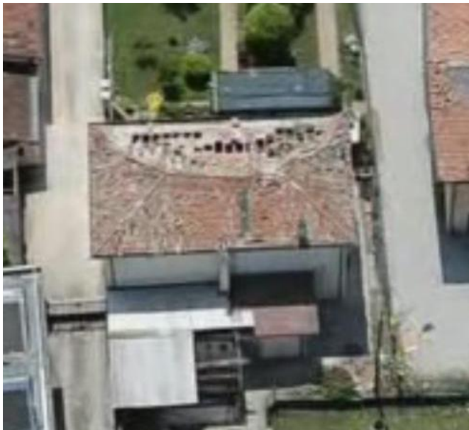
IMMAGINE 1: D.I. DANNEGGIATO
