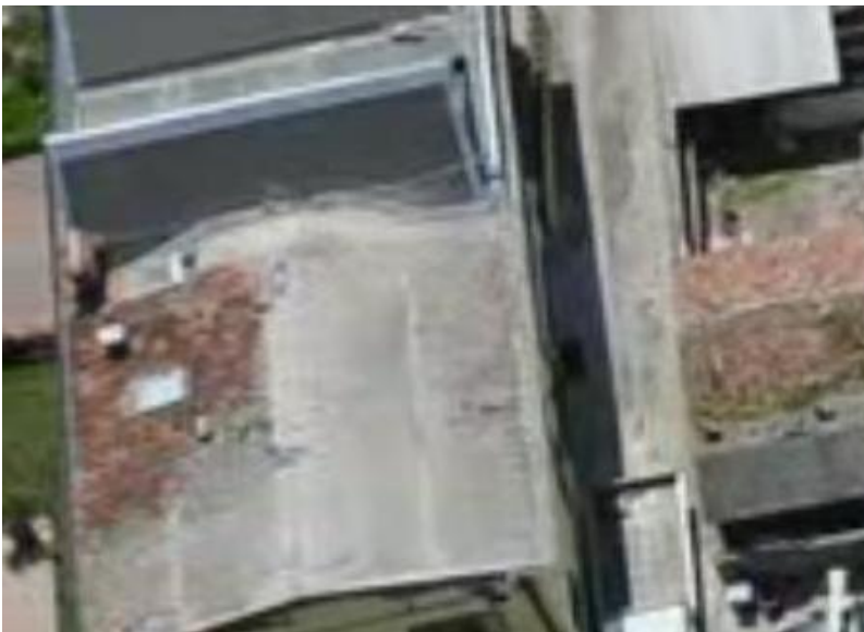
IMMAGINE 1: D.I. DANNEGGIATO
