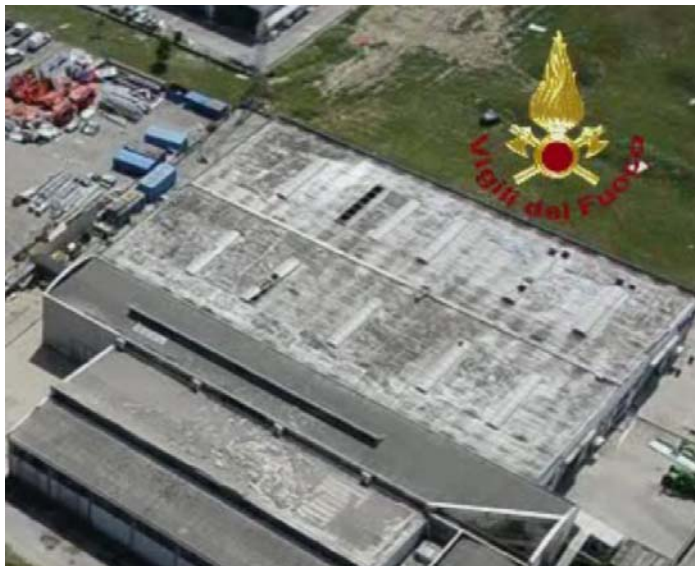
IMMAGINE 1: D.I. DANNEGGIATO
