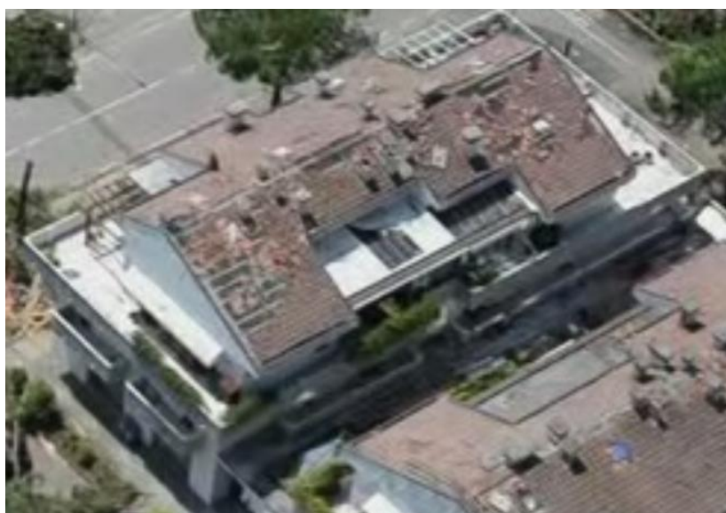
IMMAGINE 1: D.I. DANNEGGIATO
