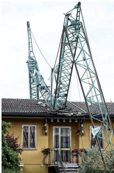
IMMAGINE 1: N.D.I. DANNEGGIATO
