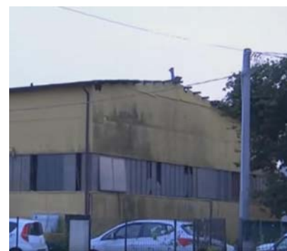
IMMAGINE 2: D.I. DANNEGGIATO O PRIMA DEL DANNO
