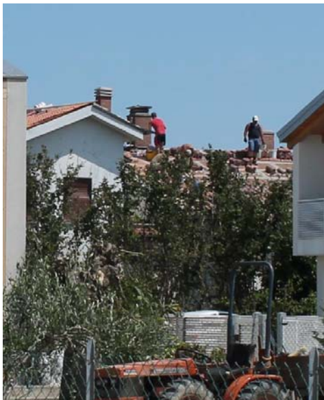
IMMAGINE 1: D.I. DANNEGGIATO
