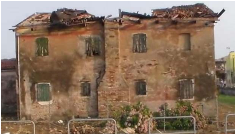
IMMAGINE 1: D.I. DANNEGGIATO
