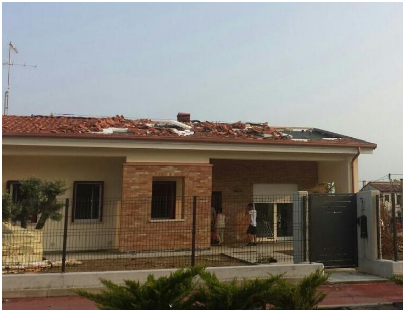
IMMAGINE 1: D.I. DANNEGGIATO
