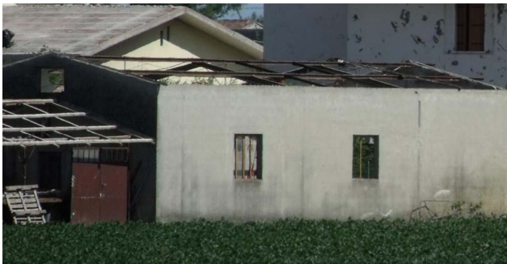
IMMAGINE 1: N.D.I. DANNEGGIATO
