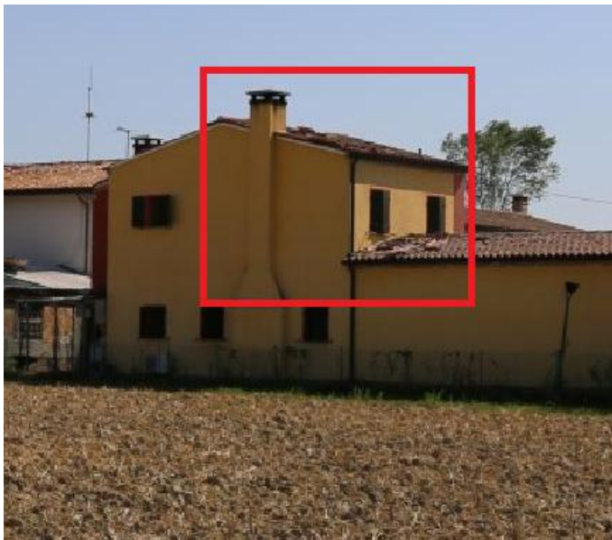
IMMAGINE 1: D.I. DANNEGGIATO
