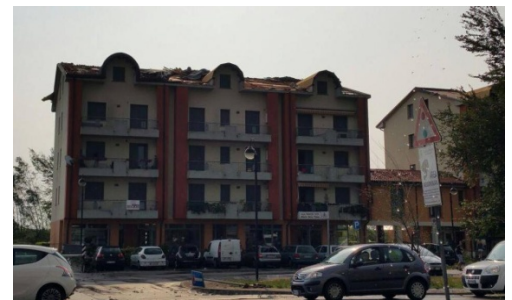
IMMAGINE 2: D.I. DANNEGGIATO O PRIMA DEL DANNO
