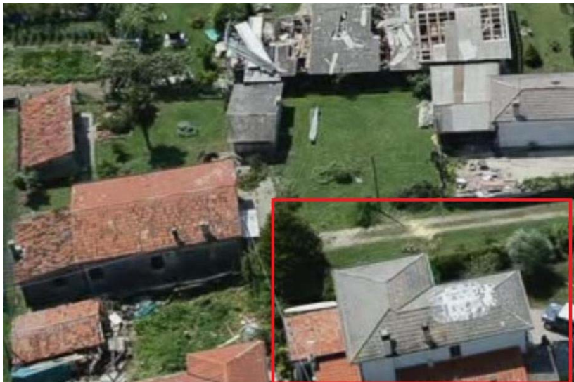
IMMAGINE 1: D.I. DANNEGGIATO
