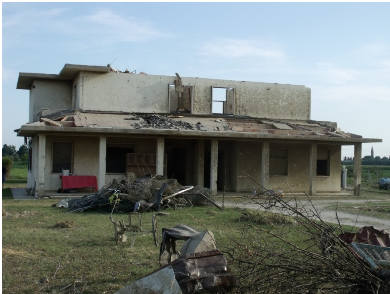
IMMAGINE 1: D.I. DANNEGGIATO
