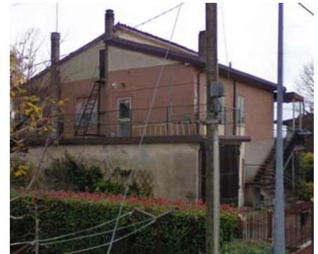
IMMAGINE 2: D.I. DANNEGGIATO O PRIMA DEL DANNO
