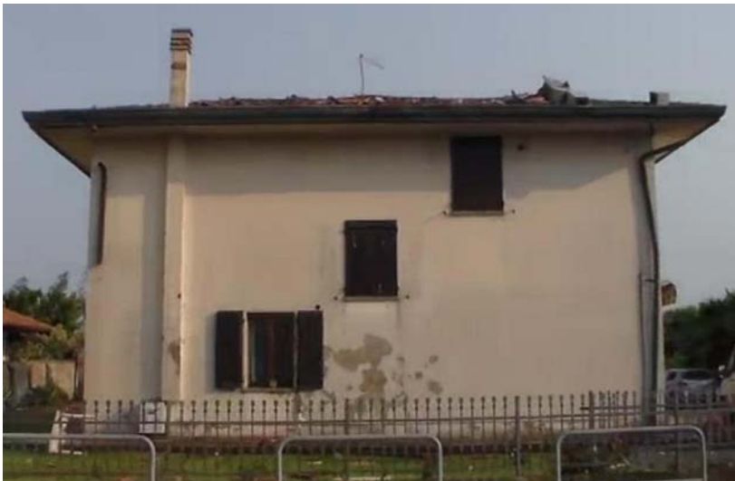
IMMAGINE 1: D.I. DANNEGGIATO
