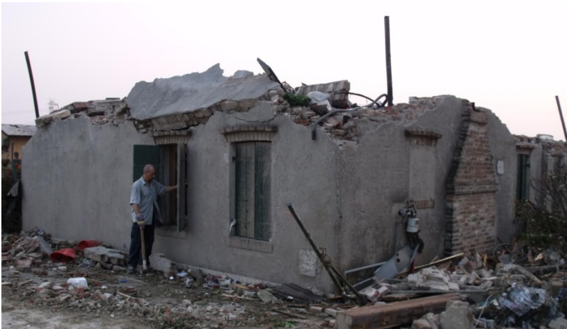
IMMAGINE 1: D.I. DANNEGGIATO
