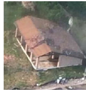
IMMAGINE 2: D.I. DANNEGGIATO O PRIMA DEL DANNO
