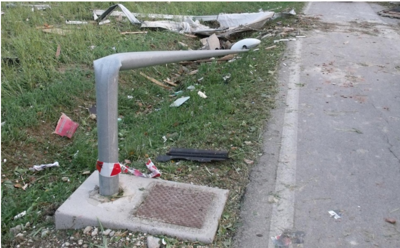
IMMAGINE 1: D.I. DANNEGGIATO
