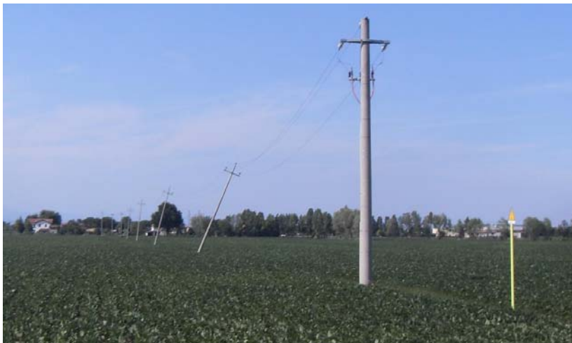
IMMAGINE 1: D.I. DANNEGGIATO
