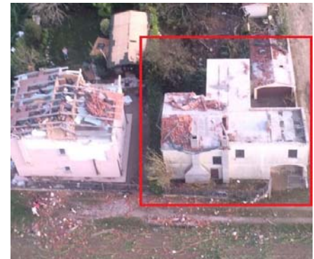
IMMAGINE 2: D.I. DANNEGGIATO O PRIMA DEL DANNO
