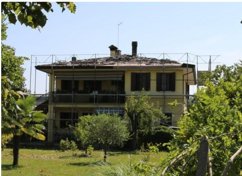
IMMAGINE 1: D.I. DANNEGGIATO
