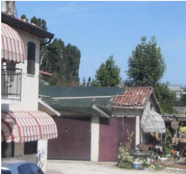
IMMAGINE 1: D.I. DANNEGGIATO
