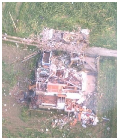
IMMAGINE 3: D.I. DANNEGGIATO
