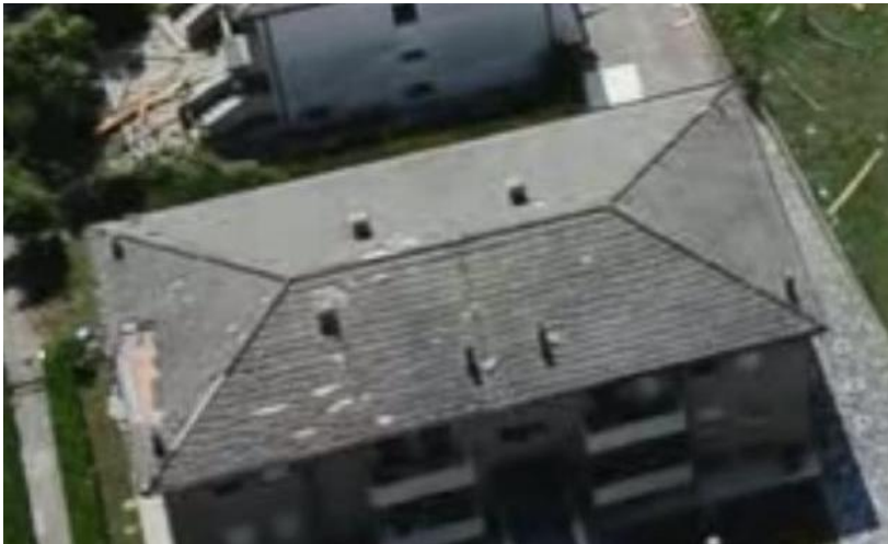
IMMAGINE 1: D.I. DANNEGGIATO
