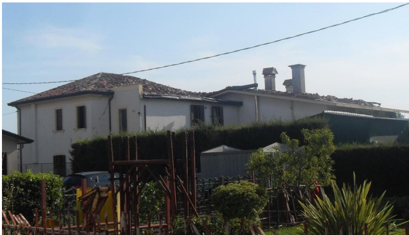
IMMAGINE 1: D.I. DANNEGGIATO
