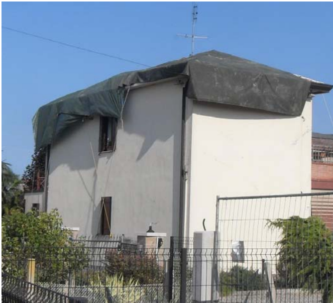
IMMAGINE 1: D.I. DANNEGGIATO
