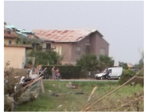
IMMAGINE 2: D.I. DANNEGGIATO O PRIMA DEL DANNO
