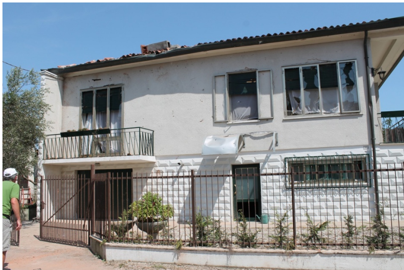
IMMAGINE 1: D.I. DANNEGGIATO
