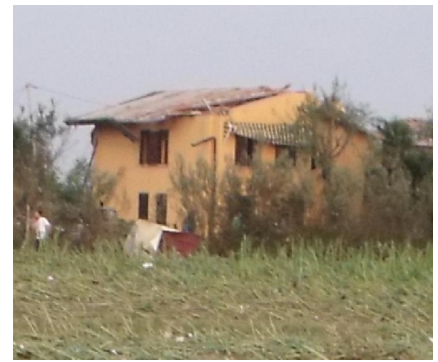
IMMAGINE 2: D.I. DANNEGGIATO O PRIMA DEL DANNO
