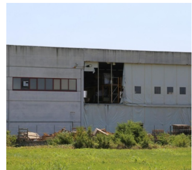
IMMAGINE 2: D.I. DANNEGGIATO O PRIMA DEL DANNO
