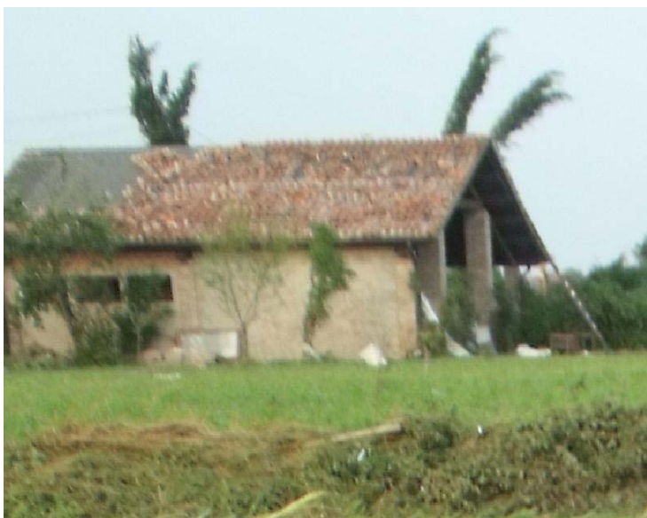
IMMAGINE 1: D.I. DANNEGGIATO
