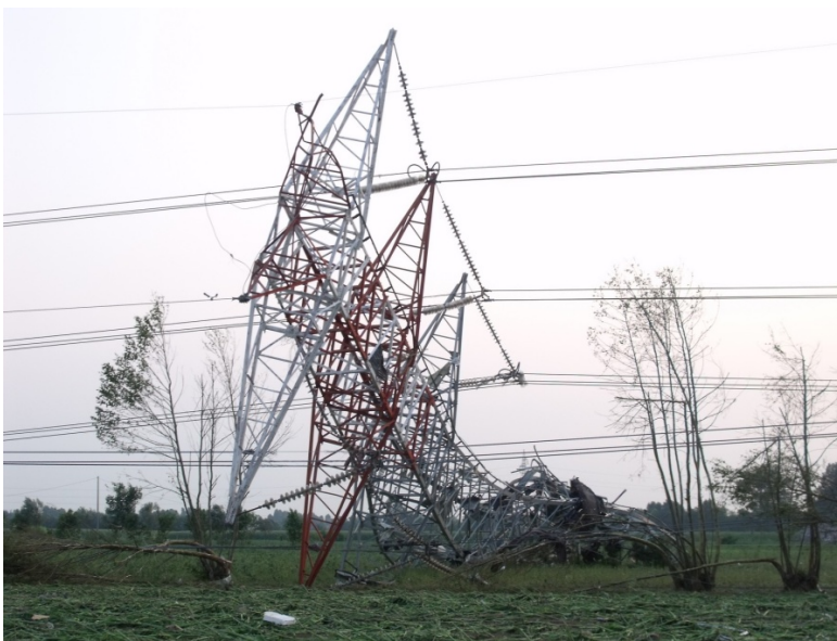
IMMAGINE 1: D.I. DANNEGGIATO
