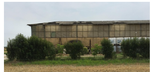
IMMAGINE 2: D.I. DANNEGGIATO O PRIMA DEL DANNO
