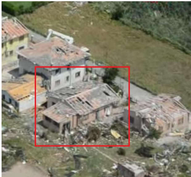
IMMAGINE 1: D.I. DANNEGGIATO
