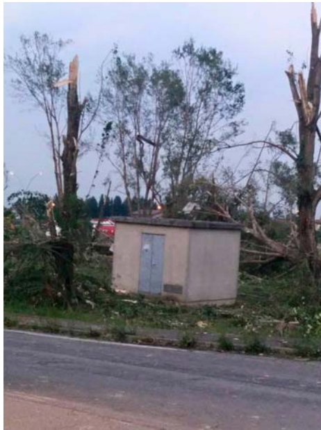
IMMAGINE 1: D.I. DANNEGGIATO
