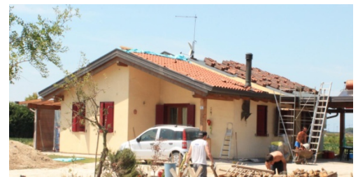
IMMAGINE 2: D.I. DANNEGGIATO O PRIMA DEL DANNO
