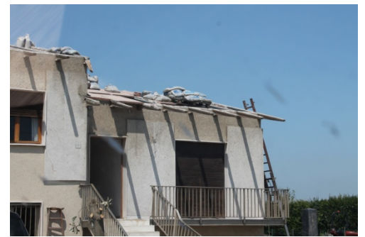
IMMAGINE 2: D.I. DANNEGGIATO O PRIMA DEL DANNO
