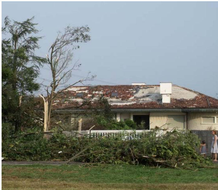
IMMAGINE 1: D.I. DANNEGGIATO
