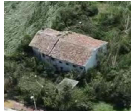
IMMAGINE 2: D.I. DANNEGGIATO O PRIMA DEL DANNO
