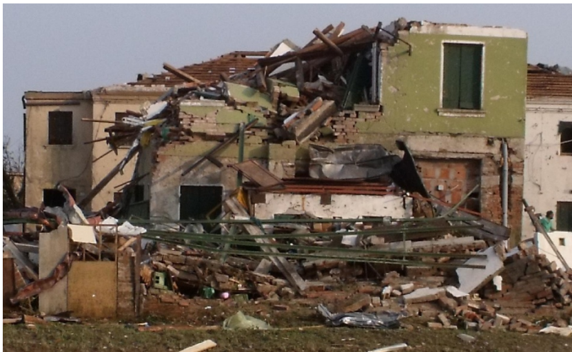
IMMAGINE 1: D.I. DANNEGGIATO
