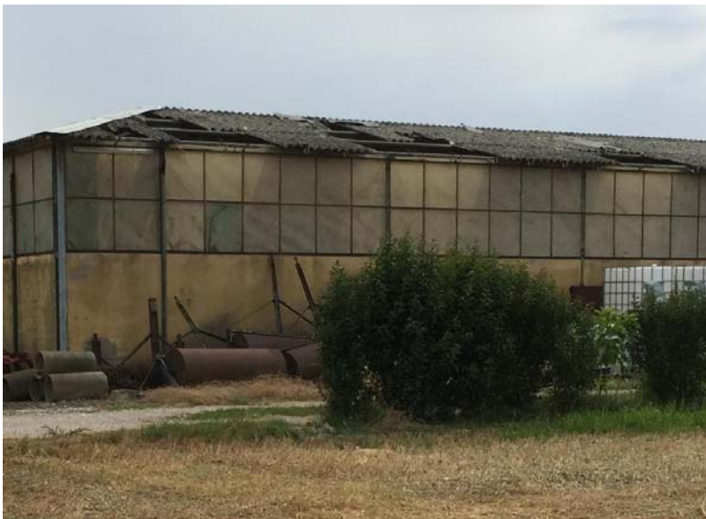
IMMAGINE 1: D.I. DANNEGGIATO
