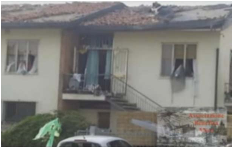
IMMAGINE 1: D.I. DANNEGGIATO
