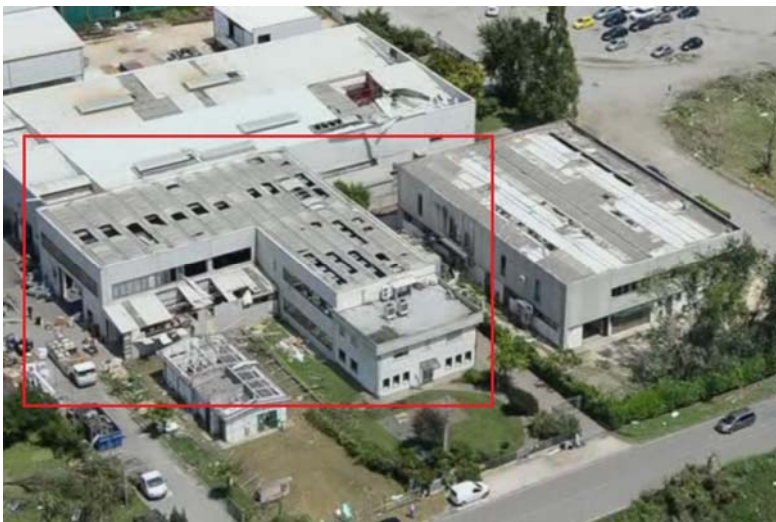
IMMAGINE 1: D.I. DANNEGGIATO
