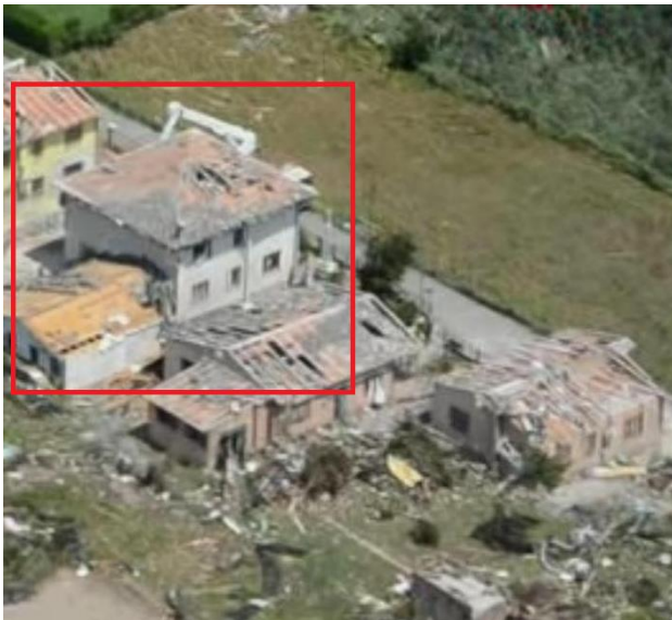
IMMAGINE 1: D.I. DANNEGGIATO
