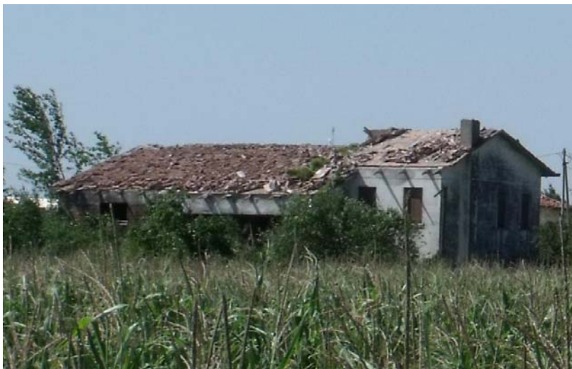
IMMAGINE 1: D.I. DANNEGGIATO
