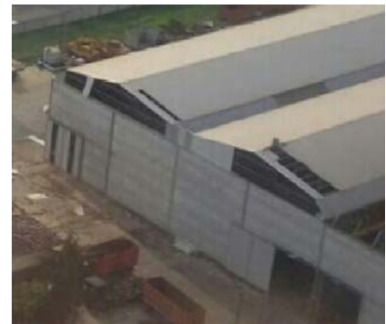
IMMAGINE 2: D.I. DANNEGGIATO O PRIMA DEL DANNO
