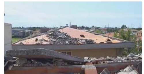
IMMAGINE 2: D.I. DANNEGGIATO O PRIMA DEL DANNO
