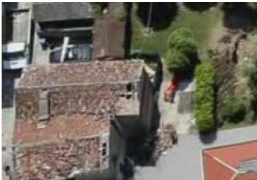
IMMAGINE 1: D.I. DANNEGGIATO
