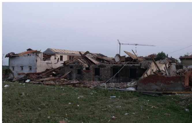
IMMAGINE 3: D.I. DANNEGGIATO
