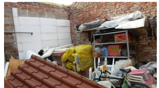
IMMAGINE 2: D.I. DANNEGGIATO O PRIMA DEL DANNO
