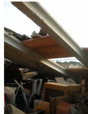
IMMAGINE 2: D.I. DANNEGGIATO O PRIMA DEL DANNO
