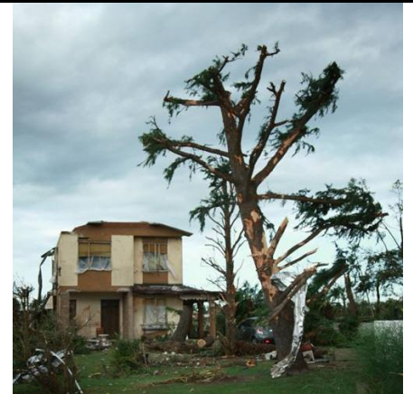
IMMAGINE 2: D.I. DANNEGGIATO O PRIMA DEL DANNO
