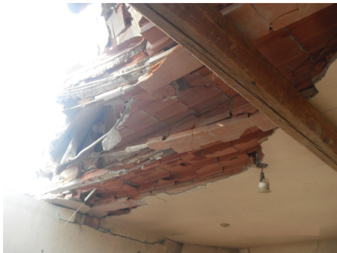
IMMAGINE 7: D.I. DANNEGGIATO
