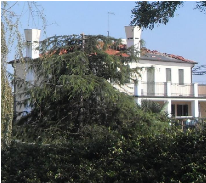
IMMAGINE 1: D.I. DANNEGGIATO
