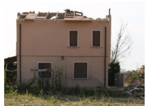
IMMAGINE 2: D.I. DANNEGGIATO O PRIMA DEL DANNO
