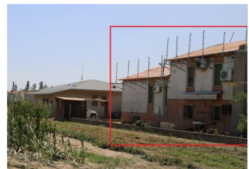
IMMAGINE 2: D.I. DANNEGGIATO O PRIMA DEL DANNO
