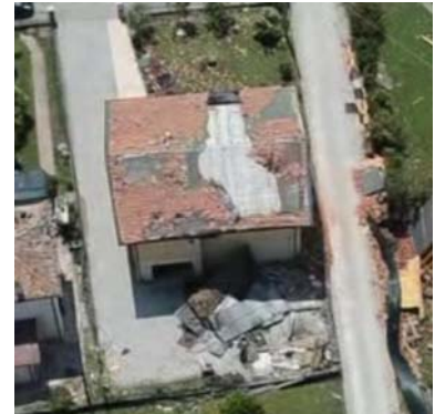
IMMAGINE 2: D.I. DANNEGGIATO O PRIMA DEL DANNO
