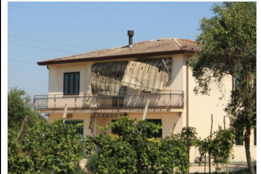
IMMAGINE 2: D.I. DANNEGGIATO O PRIMA DEL DANNO
