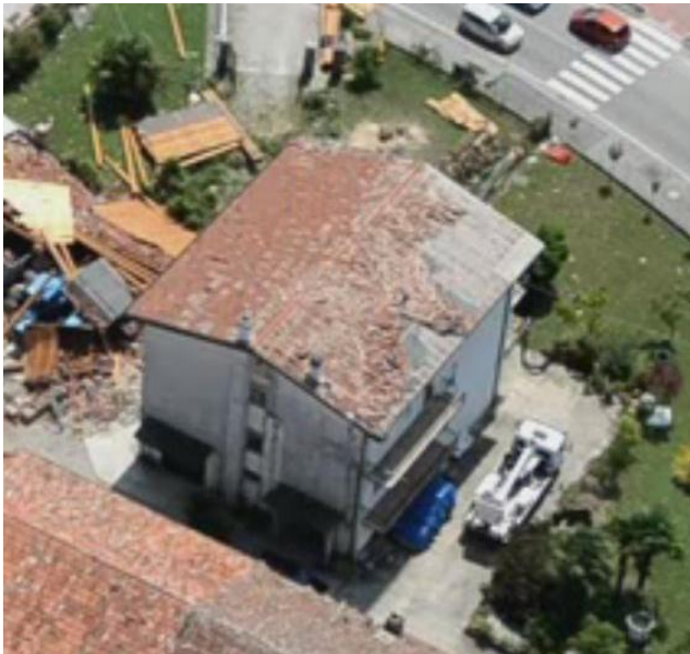
IMMAGINE 1: D.I. DANNEGGIATO
