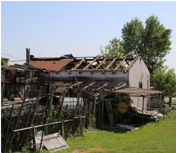
IMMAGINE 1: D.I. DANNEGGIATO
