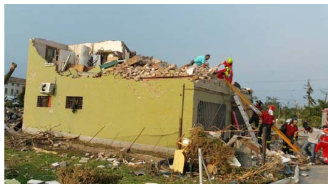
IMMAGINE 7: D.I. DANNEGGIATO
