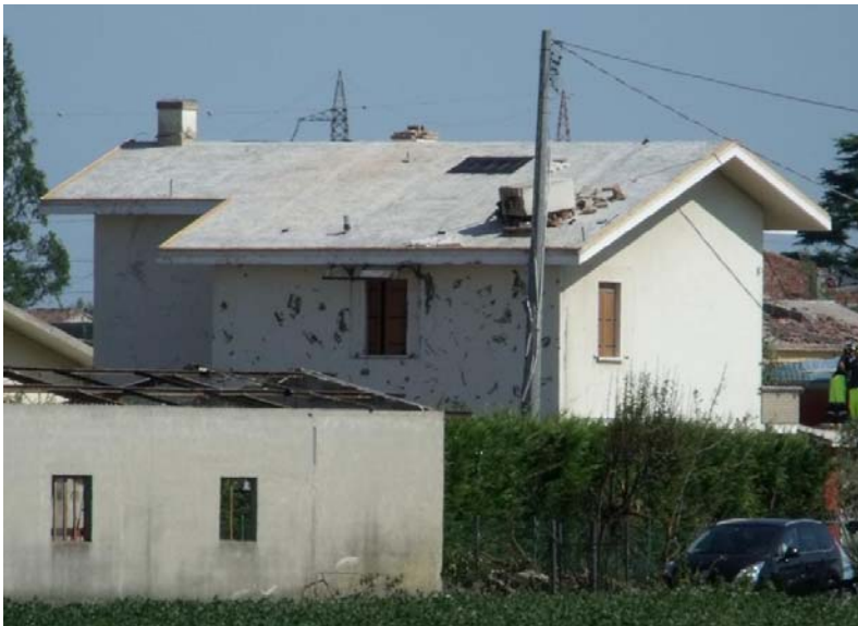
IMMAGINE 1: D.I. DANNEGGIATO
