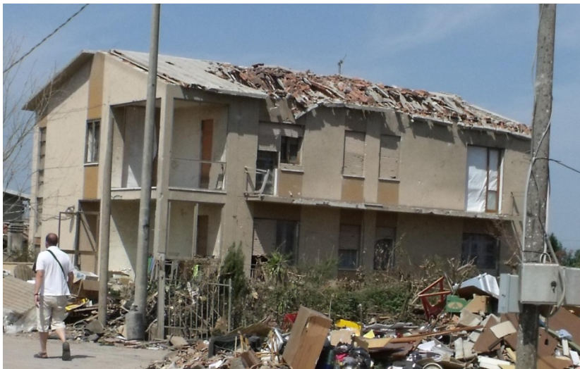
IMMAGINE 1: D.I. DANNEGGIATO
