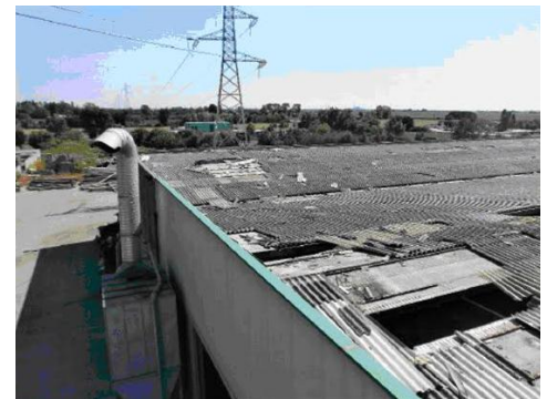
IMMAGINE 2: D.I. DANNEGGIATO O PRIMA DEL DANNO
