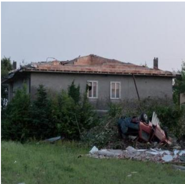
IMMAGINE 1: D.I. DANNEGGIATO
