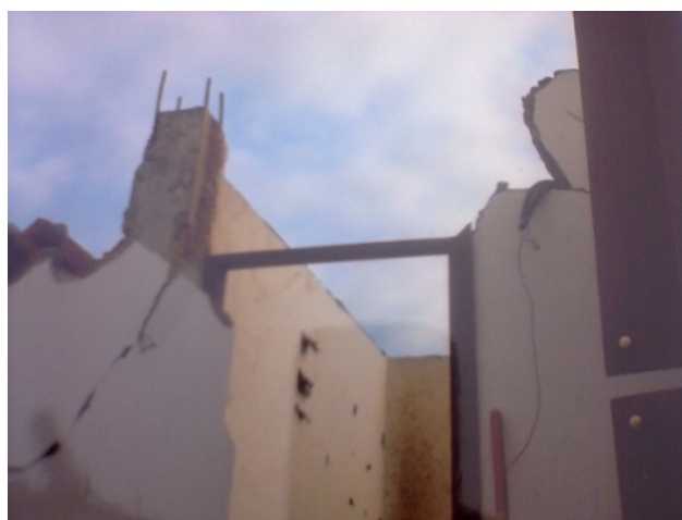
IMMAGINE 8: D.I. DANNEGGIATO
