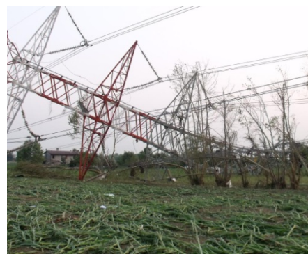
IMMAGINE 2: D.I. DANNEGGIATO O PRIMA DEL DANNO
