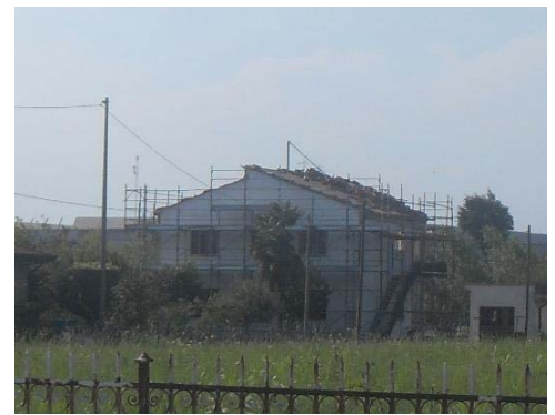
IMMAGINE 2: D.I. DANNEGGIATO O PRIMA DEL DANNO
