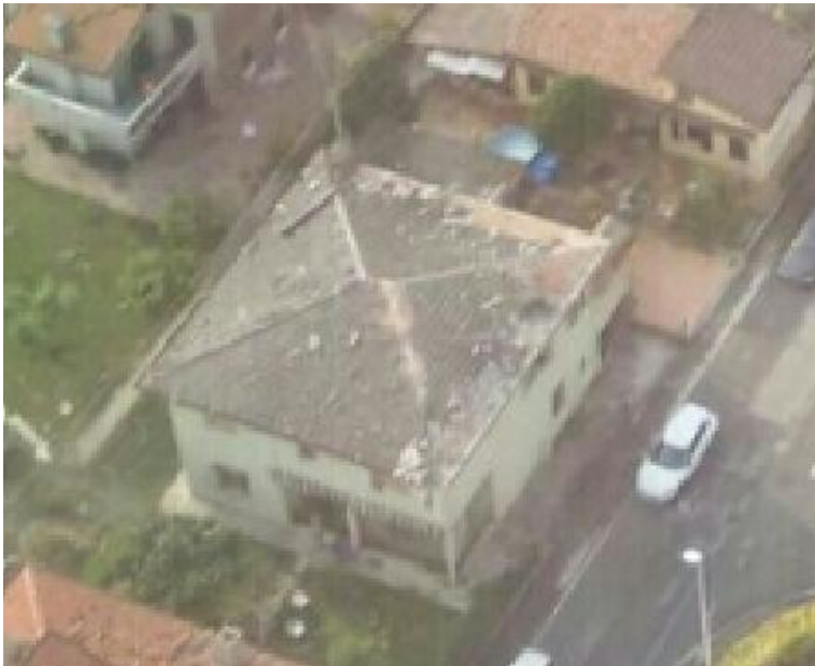
IMMAGINE 1: D.I. DANNEGGIATO
