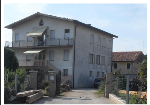
IMMAGINE 2: D.I. DANNEGGIATO O PRIMA DEL DANNO
