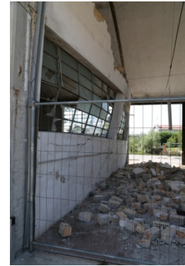
IMMAGINE 2: D.I. DANNEGGIATO O PRIMA DEL DANNO
