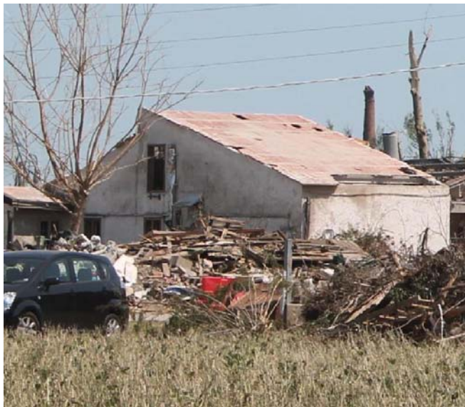
IMMAGINE 1: D.I. DANNEGGIATO
