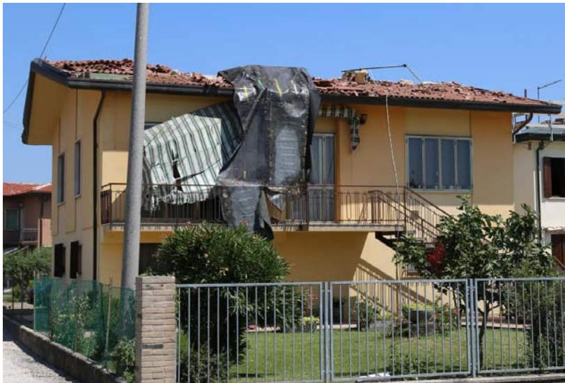
IMMAGINE 1: D.I. DANNEGGIATO
