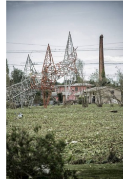
IMMAGINE 2: D.I. DANNEGGIATO O PRIMA DEL DANNO
