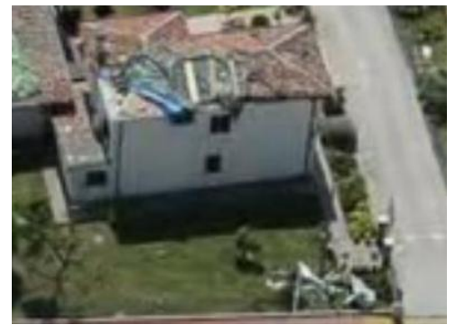
IMMAGINE 2: D.I. DANNEGGIATO O PRIMA DEL DANNO
