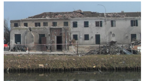
IMMAGINE 2: D.I. DANNEGGIATO O PRIMA DEL DANNO
