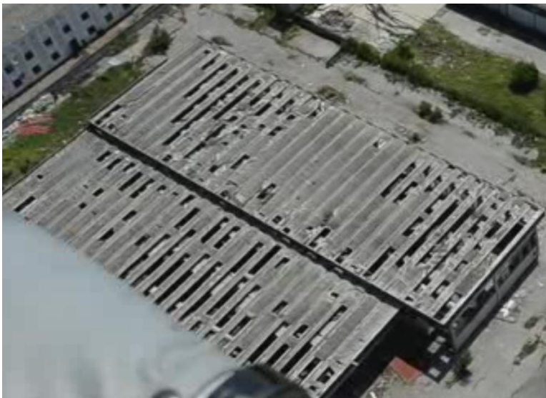
IMMAGINE 1: D.I. DANNEGGIATO
