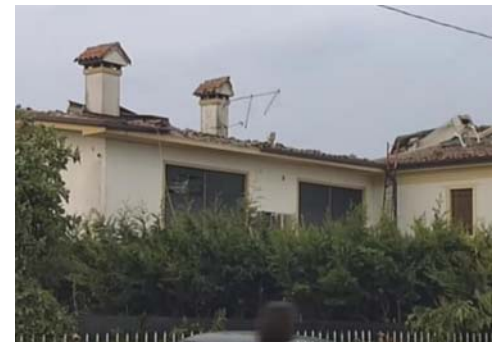
IMMAGINE 2: D.I. DANNEGGIATO O PRIMA DEL DANNO
