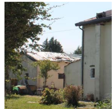
IMMAGINE 2: D.I. DANNEGGIATO O PRIMA DEL DANNO
