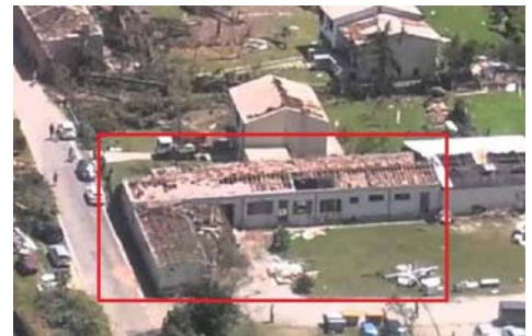
IMMAGINE 2: D.I. DANNEGGIATO O PRIMA DEL DANNO
