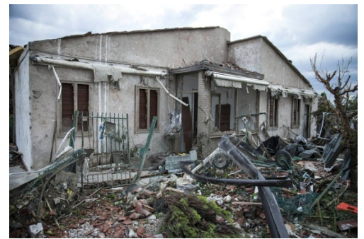
IMMAGINE 2: D.I. DANNEGGIATO O PRIMA DEL DANNO
