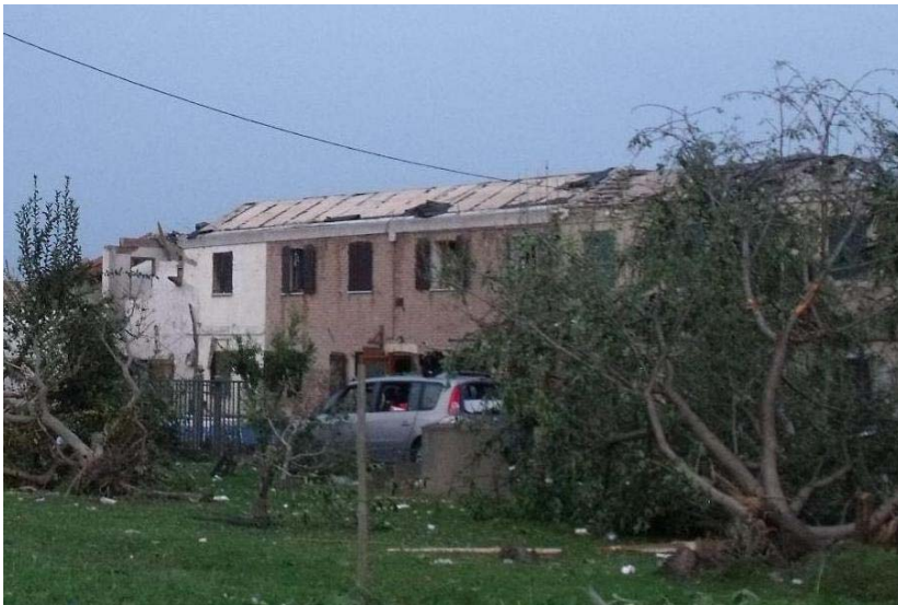
IMMAGINE 1: D.I. DANNEGGIATO
