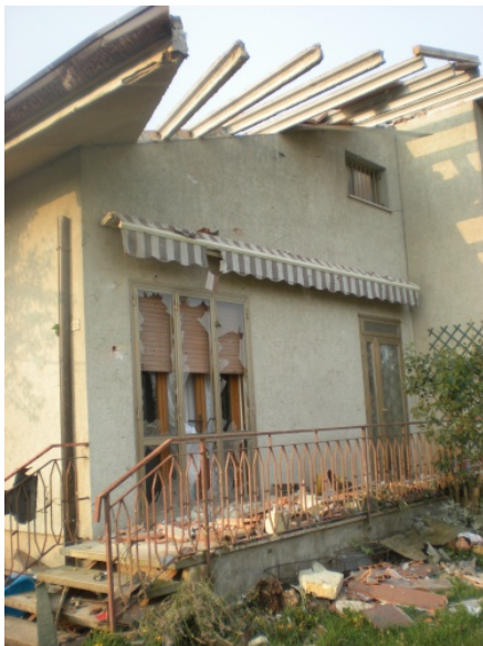
IMMAGINE 1: D.I. DANNEGGIATO
