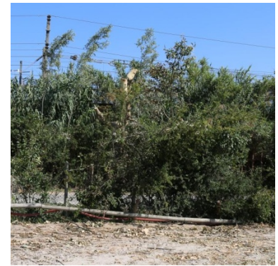
IMMAGINE 2: D.I. DANNEGGIATO O PRIMA DEL DANNO
