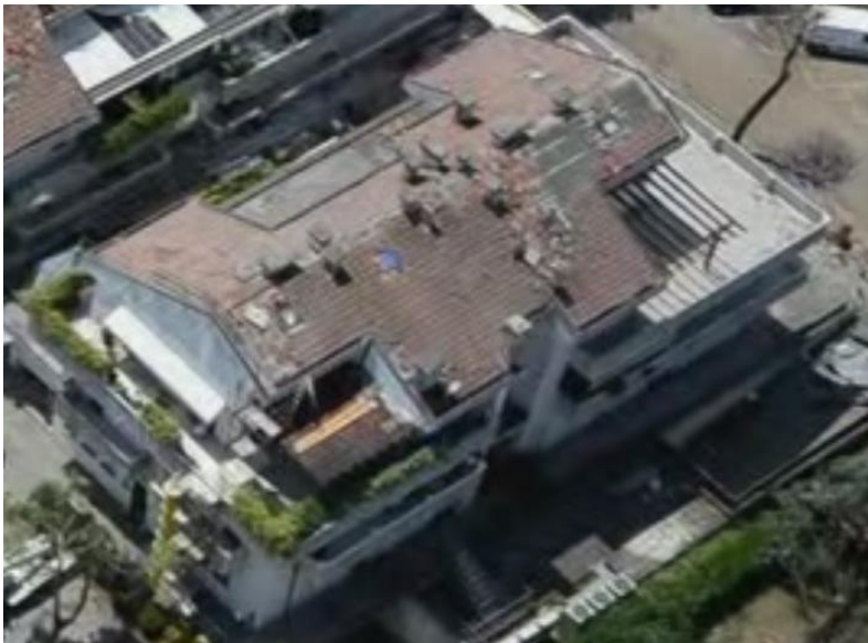
IMMAGINE 1: D.I. DANNEGGIATO
