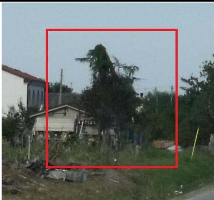
IMMAGINE 1: D.I. DANNEGGIATO
