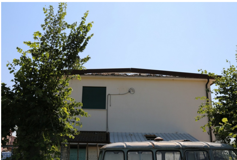
IMMAGINE 1: D.I. DANNEGGIATO
