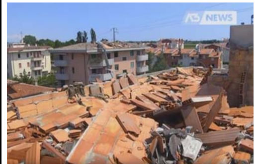
IMMAGINE 2: D.I. DANNEGGIATO O PRIMA DEL DANNO
