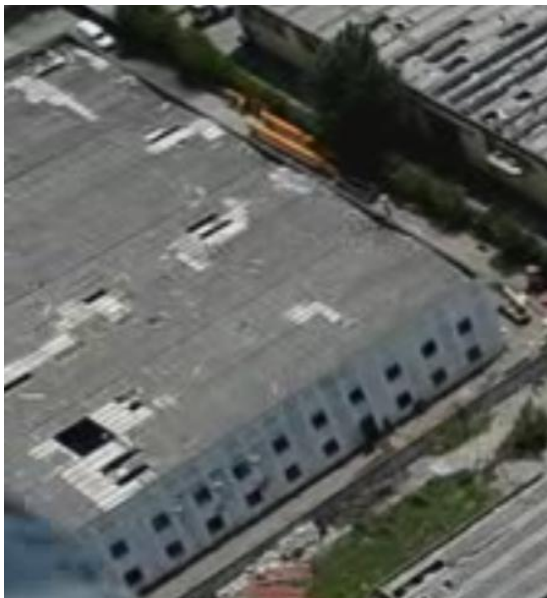
IMMAGINE 1: D.I. DANNEGGIATO
