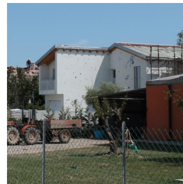
IMMAGINE 2: D.I. DANNEGGIATO O PRIMA DEL DANNO
