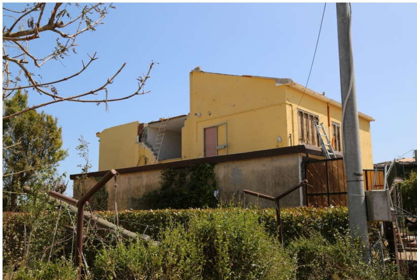
IMMAGINE 1: D.I. DANNEGGIATO
