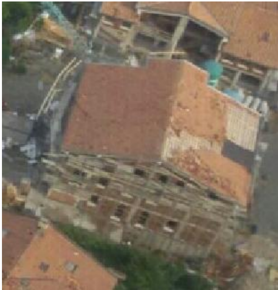
IMMAGINE 1: D.I. DANNEGGIATO
