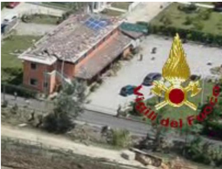
IMMAGINE 1: D.I. DANNEGGIATO
