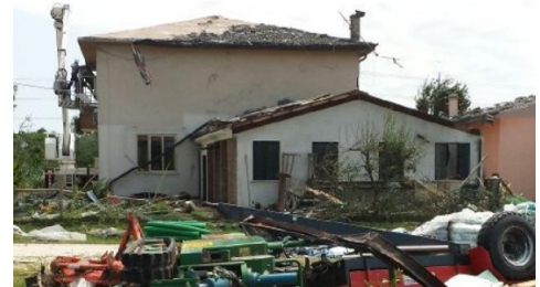
IMMAGINE 2: D.I. DANNEGGIATO O PRIMA DEL DANNO
