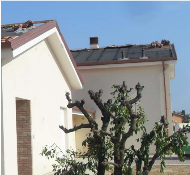
IMMAGINE 1: D.I. DANNEGGIATO
