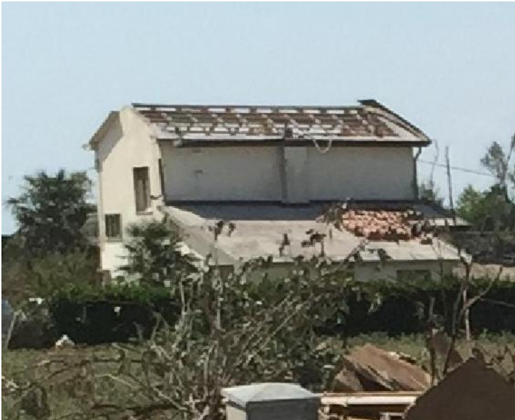
IMMAGINE 1: D.I. DANNEGGIATO
