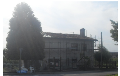
IMMAGINE 2: D.I. DANNEGGIATO O PRIMA DEL DANNO
