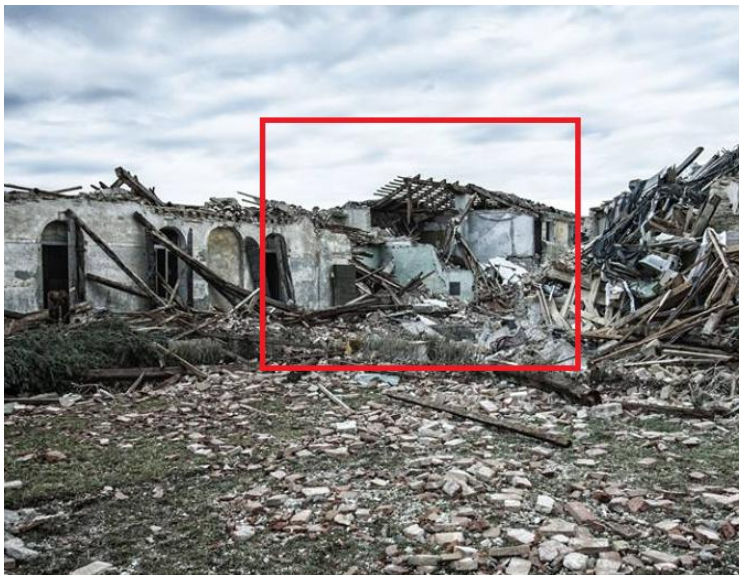
IMMAGINE 1: D.I. DANNEGGIATO
