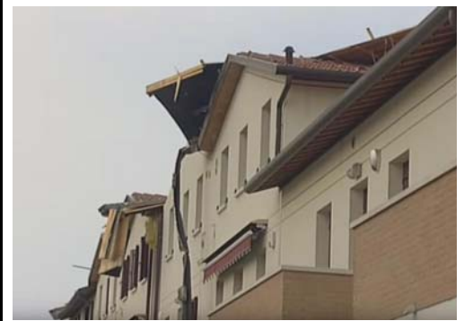
IMMAGINE 2: D.I. DANNEGGIATO O PRIMA DEL DANNO
