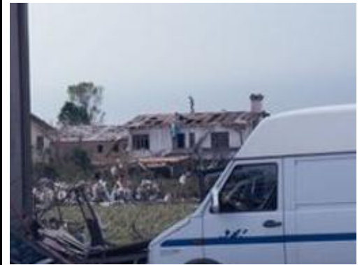
IMMAGINE 2: D.I. DANNEGGIATO O PRIMA DEL DANNO
