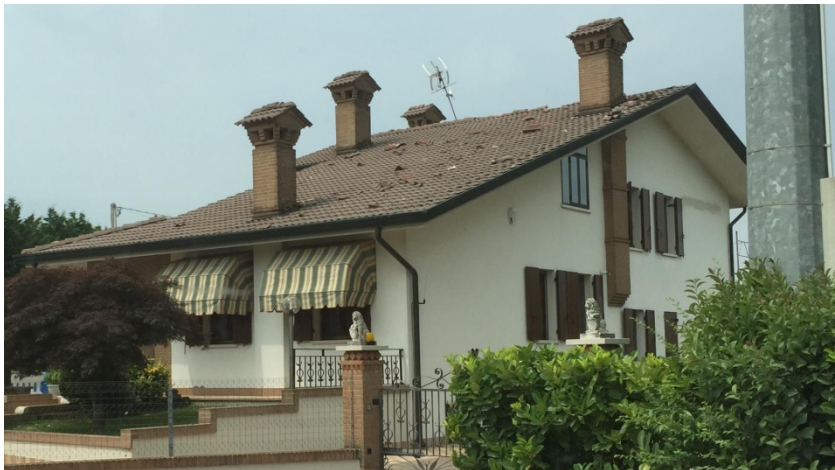
IMMAGINE 1: D.I. DANNEGGIATO
