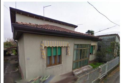
IMMAGINE 2: D.I. DANNEGGIATO O PRIMA DEL DANNO
