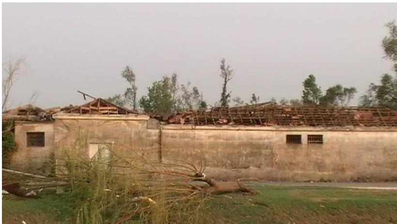
IMMAGINE 1: D.I. DANNEGGIATO
