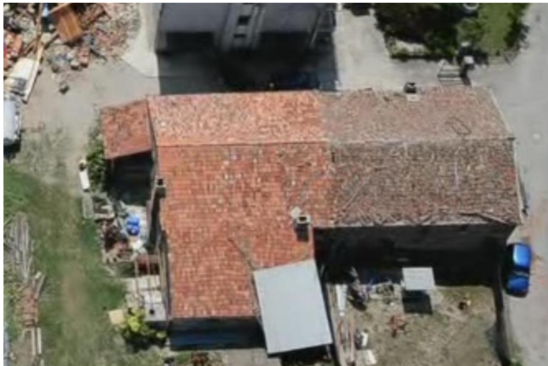
IMMAGINE 1: D.I. DANNEGGIATO
