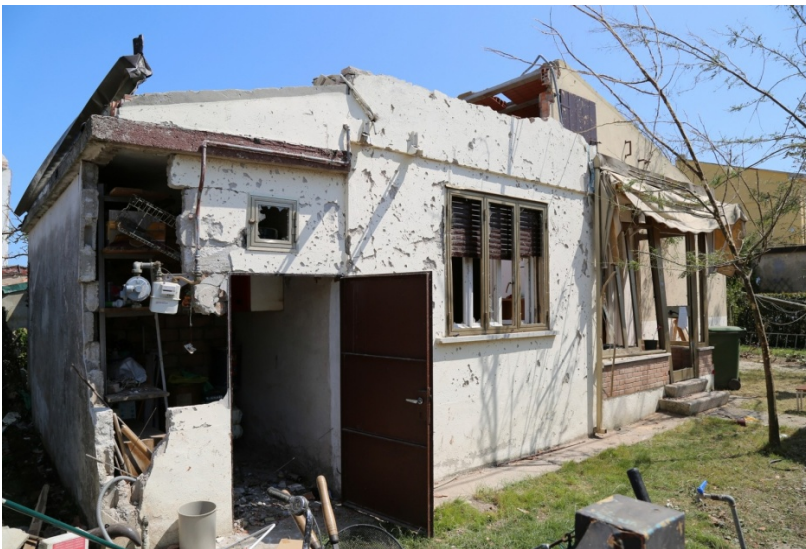
IMMAGINE 1: D.I. DANNEGGIATO
