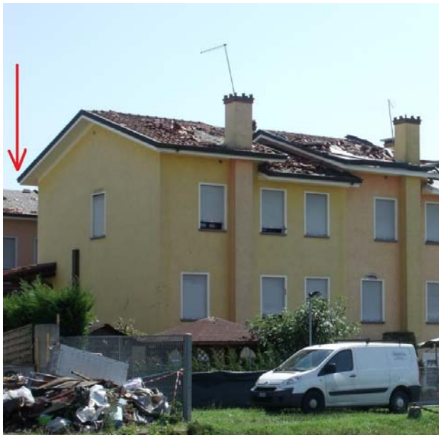
IMMAGINE 1: D.I. DANNEGGIATO
