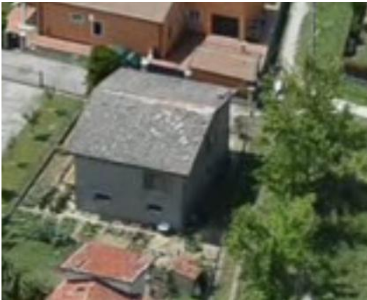
IMMAGINE 1: D.I. DANNEGGIATO
