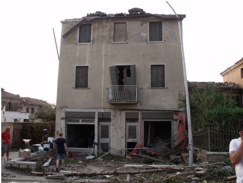
IMMAGINE 1: D.I. DANNEGGIATO
