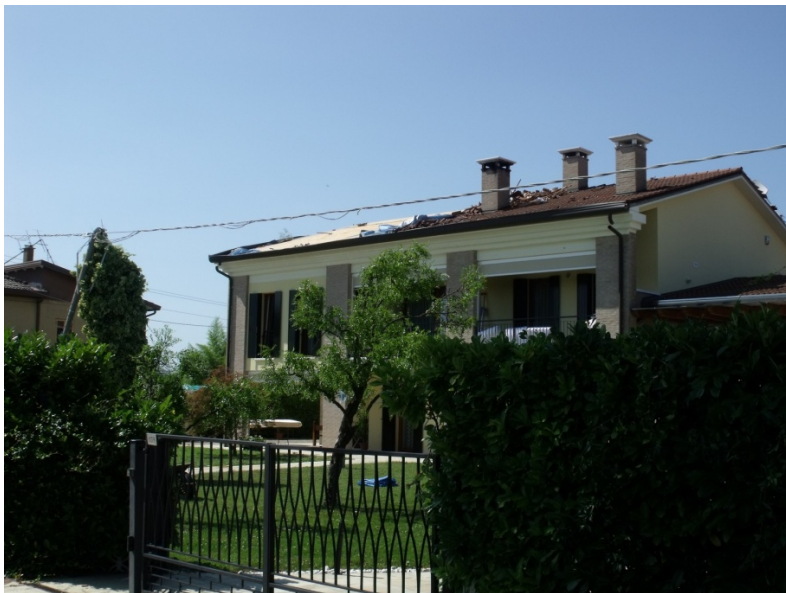
IMMAGINE 1: D.I. DANNEGGIATO
