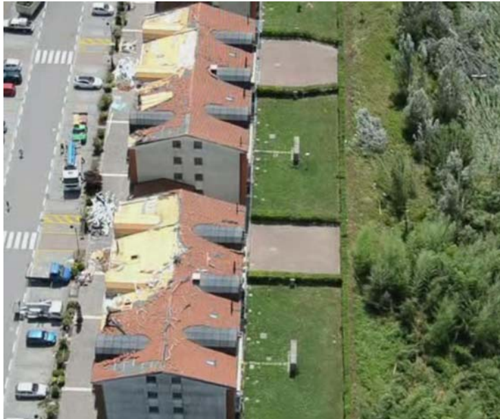
IMMAGINE 1: D.I. DANNEGGIATO
