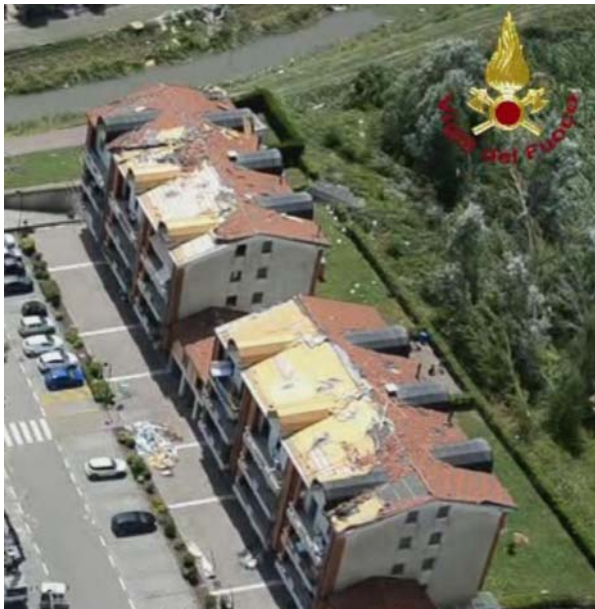
IMMAGINE 1: D.I. DANNEGGIATO
