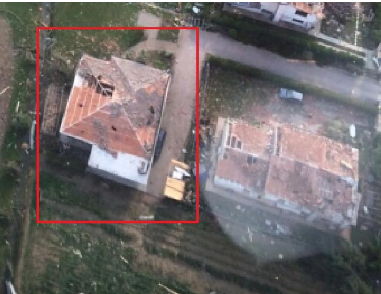
IMMAGINE 1: D.I. DANNEGGIATO
