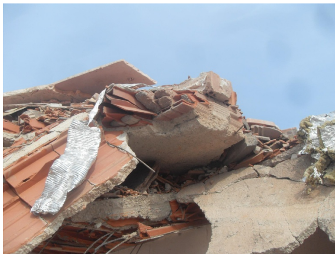
IMMAGINE 8: D.I. DANNEGGIATO
