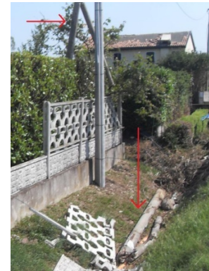
IMMAGINE 2: D.I. DANNEGGIATO O PRIMA DEL DANNO
