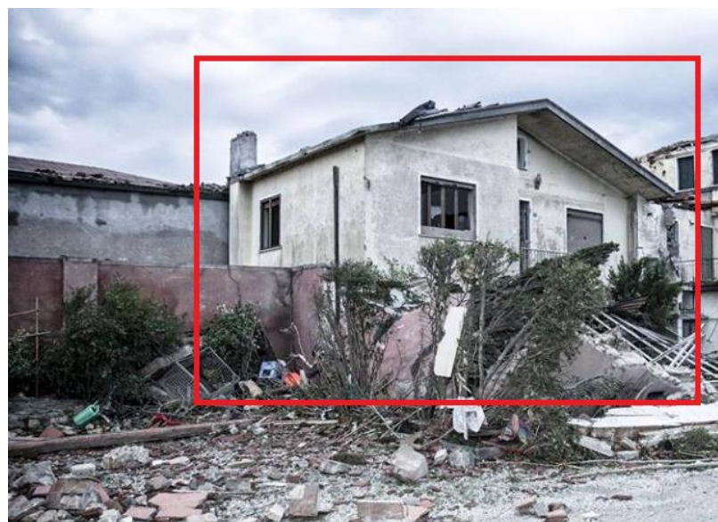
IMMAGINE 1: D.I. DANNEGGIATO
