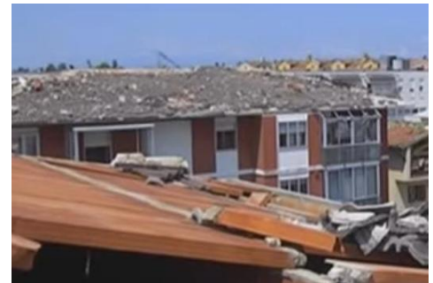
IMMAGINE 2: D.I. DANNEGGIATO O PRIMA DEL DANNO
