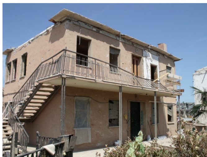
IMMAGINE 6: D.I. DANNEGGIATO
